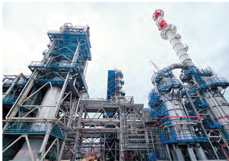
Новая установка гидроочистки бензиновых и дизельных фракций будет производить 600 тыс. тонн продукции в год
